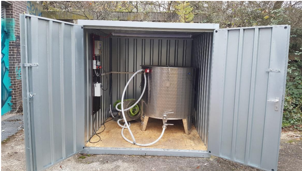
Abbildung A 1: Feststoffsammler am Pumpwerk 13
