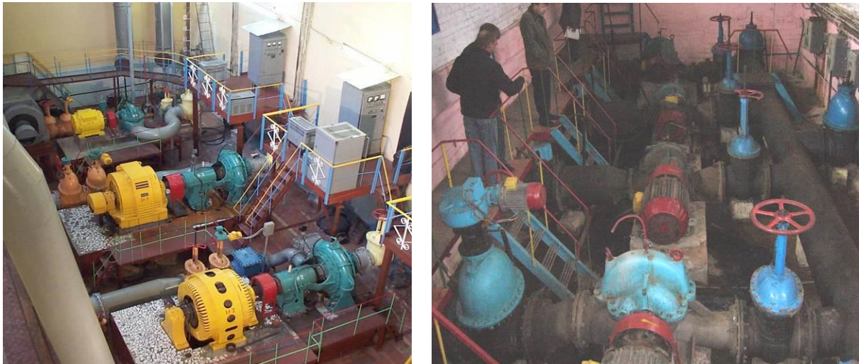
Малюнок 7: Сучасні (м. Чернівці, зліва) і застарілі насосні станції (м. Червоноград, справа)
