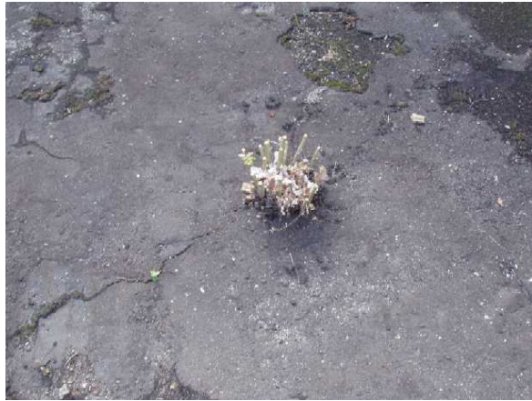
Abbildung 20: Zerstörte Dichtfläche durch Pflanzen
