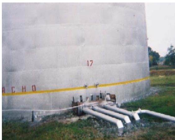
Фотография 3: Плоскодонная ёмкость в поддоне из глинистого грунта с обваловкой
