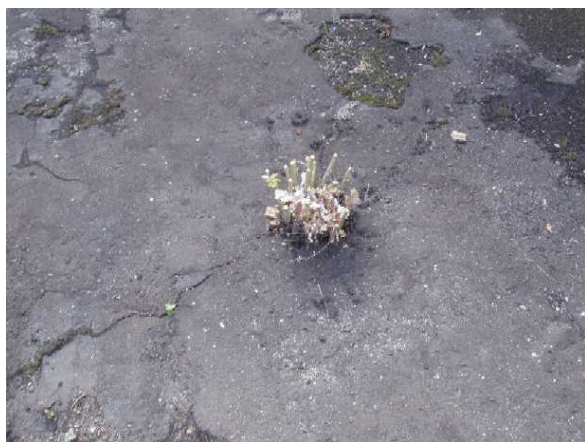
Фотография 20: Повреждения уплотнительной поверхности, вызванные растениями
